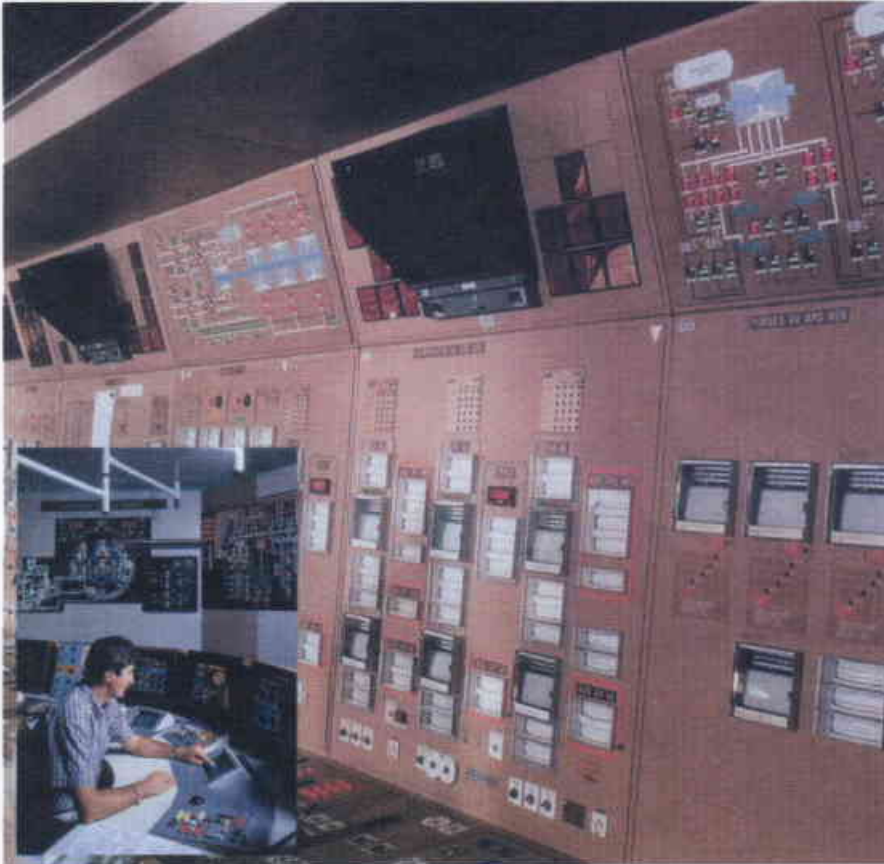
ردهة التحكم في القسم 2 من محطة توليد الكهرباء التابعة لكهرباء فرنسا EDF في فولدفيش (gold fech) المحاكيات "بالمقياس الكامل" هي نسخ مطابقة تماماً لرداهات التحكم الواقعية. في اللوحة الجدارية، محاكي القيادة في محطة توليد الكهرباء التابعة لكهرباء فرنسا هي بوجيه في نهاية الثمانينات.
